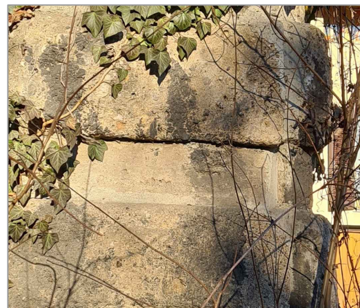
Interventi precedenti e stuccature deturpanti
