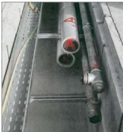
TUBAZIONI ALL'INTERNO DI UN CUNICOLO TECNOLOGICO
